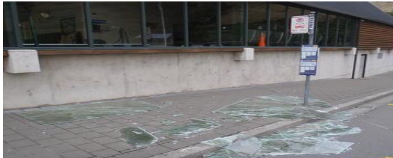
Figura 48- Ejemplo de rompimiento de ventanas durante el terremoto de Chrischurh en Nueva Zelanda en Febrero de 2011
