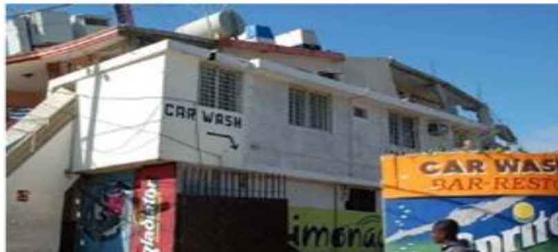
Figura 34- Daños por Pesos en Cubierta. Sismo de Haití de 2010
