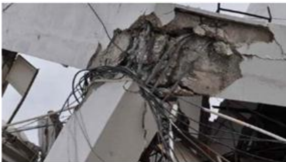
Figura 31- Daños por nudos. Sismo de Haití de 2010
