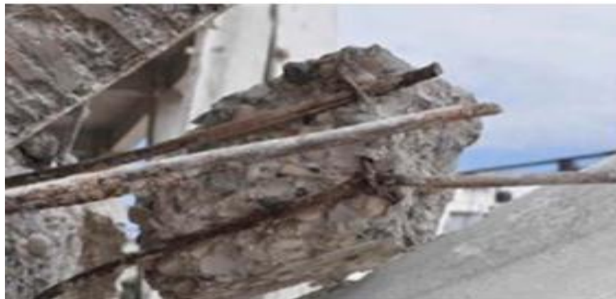
Figura 35- Daño por calidad de materiales
