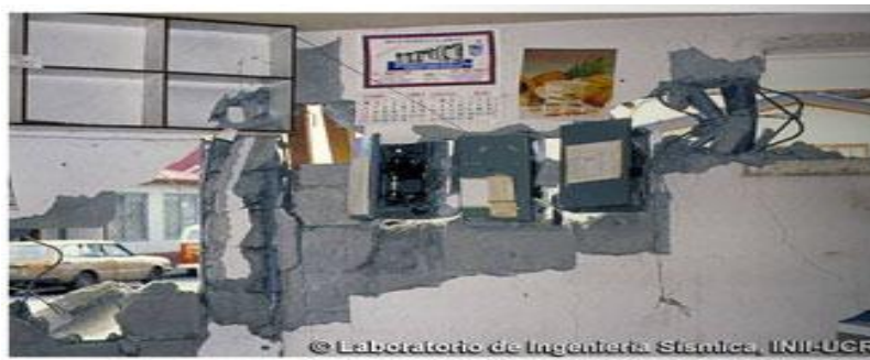
Figura 49- Ejemplo de daño no estructural en una pared en Alajuela durante el terremoto del 22 de Diciembre de 1990
