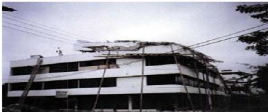
Figura 29 Daño por Irregularidad en elevación. Sismo de Ecuador de 1998
