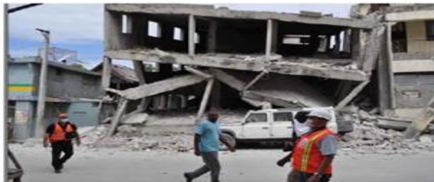
Figura 32- Daños por Golpeteo de Edificios.
