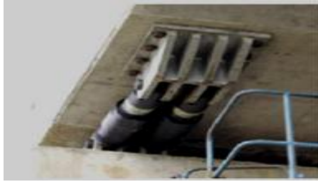
Figura 66- Disipadores RESTON STU.
