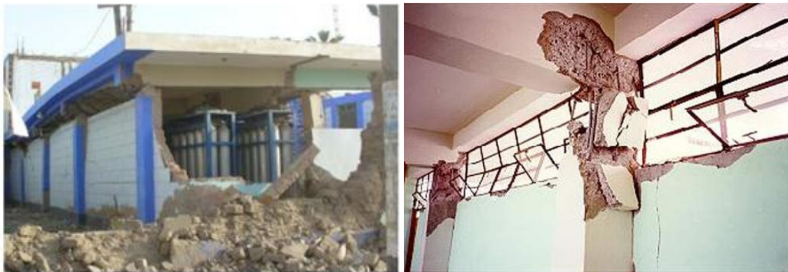
Figura 25- Daño por columna corta. Sismo de Perú de 2007
