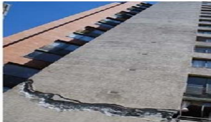
Figura 23- Daño por corte Cizalle en muros. Sismo de Chile de 2010
