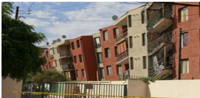
Figura 24- Daños por voladizos. Sismo de Chile de 2010
