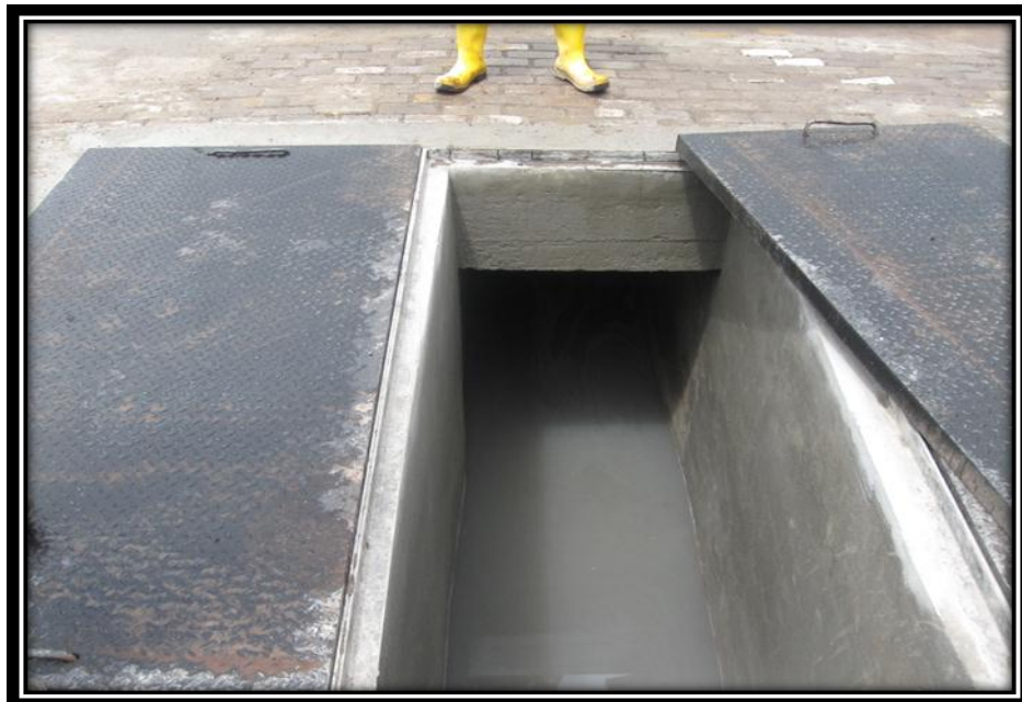
Fotografía 34. Tercer compartimiento de la trampa de grasas
