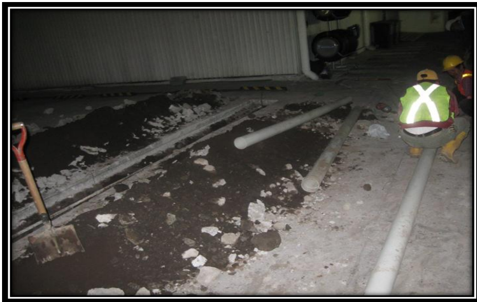
Fotografía 13. Rotura de hormigon de trafico pesado
