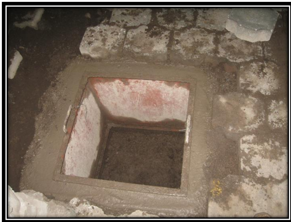
Fotografía 19. Caja de revisión
