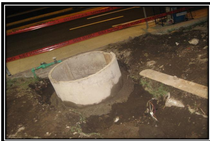
Fotografía 26. Terrenos mal compactados por trabajos realizados anteriormente como solución se abrió la zanja para evitar accidentes
