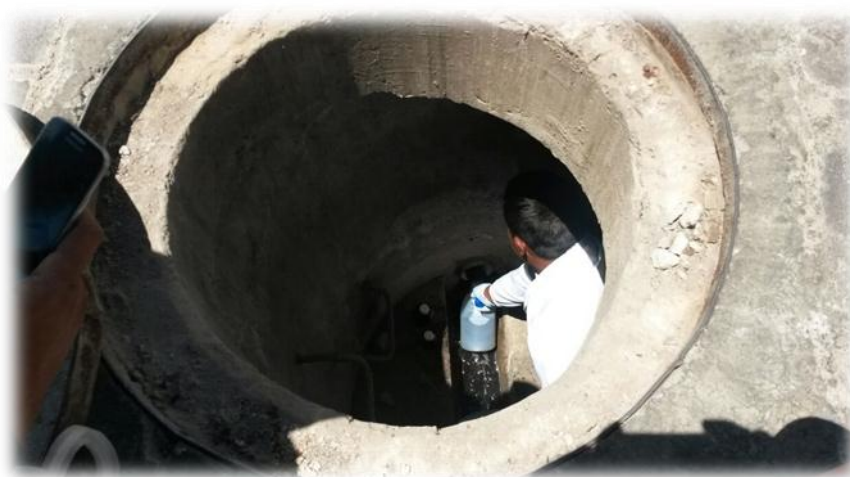
Fotografia 4. Descarga del agua de la trampa de grasa
