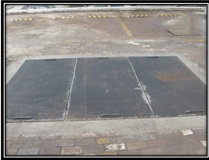
Fotografía 33. Tapas de la trampa de grasa
