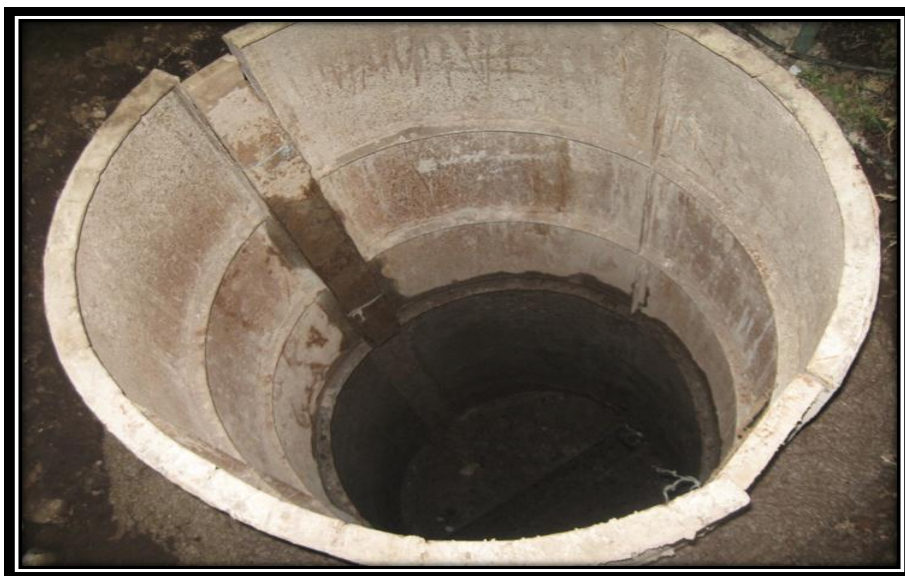
Fotografía 7. Molde de pozo principal donde descarga la trampa de grasa
