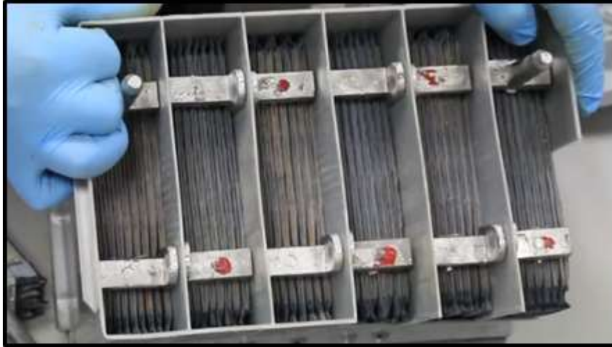
Figura. 12 Conexión de celdas
