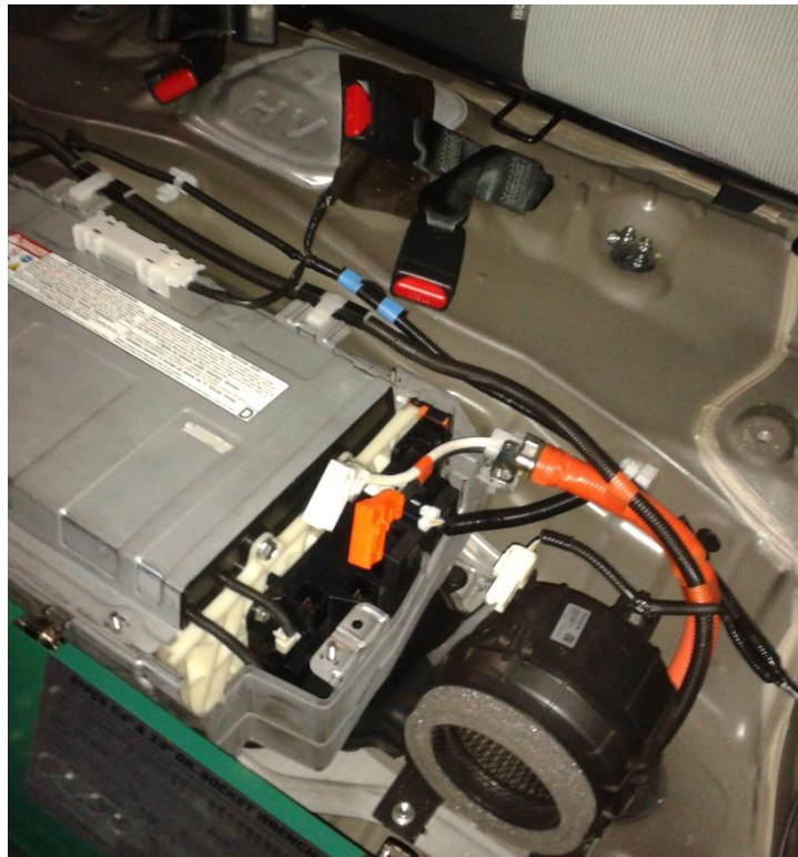
Figura 2. 7 Soplador de aire baterias
