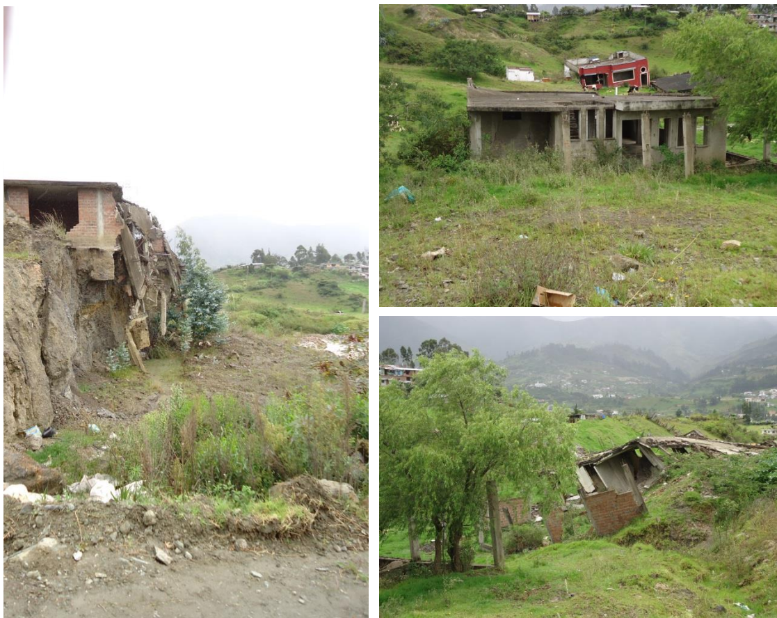
Imagen 053, 054, 055. Estructuras de vivienda en ruinas
