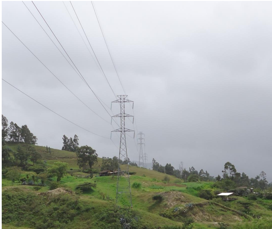
Imagen 028. Torres de conducción eléctrica en el barrio La Florida.
