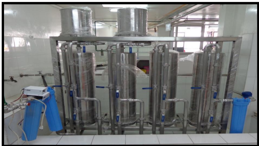
IMAGEN N° 5: PLANTA DE AGUA
