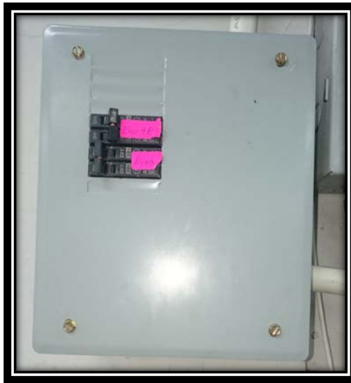
Figura 29. Breaker de arriba para el elevador y el de abajo para el dyno
