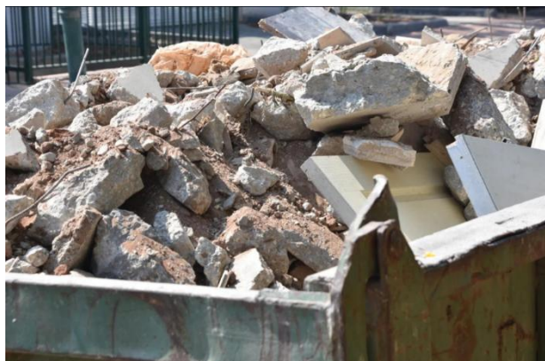
Figura 2. Acumulación de residuos de construcción y demolición.
