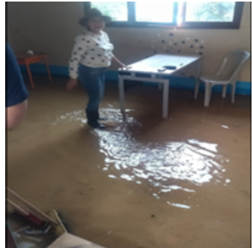
Figura 5. Aulas afectadas por las lluvias
