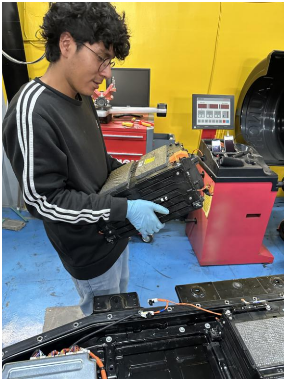
Figura 39 Extracción de los paquetes individuales del paquete de baterías
