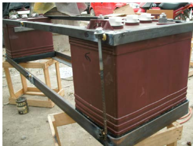
Figura 3.49 Soporte de las baterías del balde
