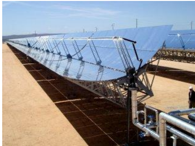
Figura 1.10. Central termosolar con colectores solares cilindro-parabólicos 10
