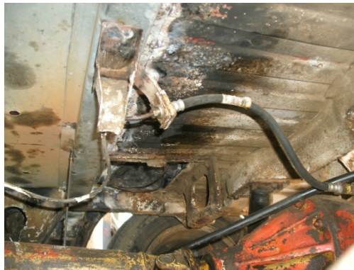
Figura 3.27 Cañerías en mal estado
