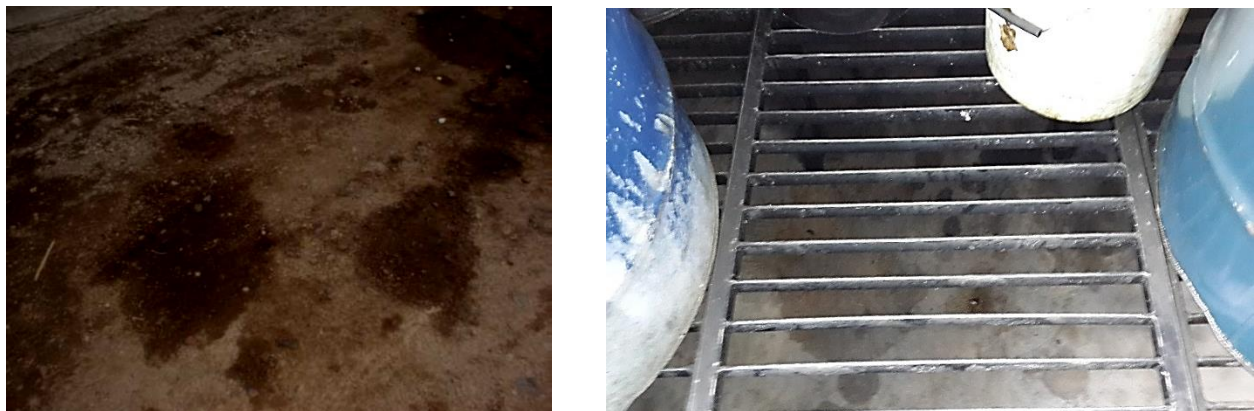
Figura 3.4 Suelos contaminados a causa de aceites lubricantes usados vs pisos impermeables
