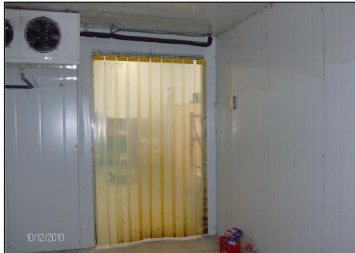
Gráfico No. 23 Vista interior del cuarto frio
