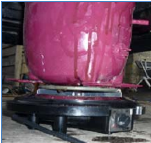
Foto No. 3.36 Sistema de calentamiento de aceite
