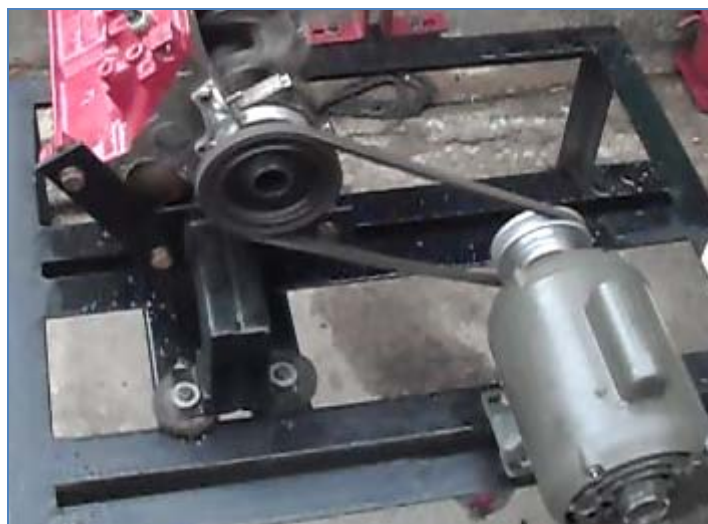
Foto No. 3.5 Motor eléctrico instalado
