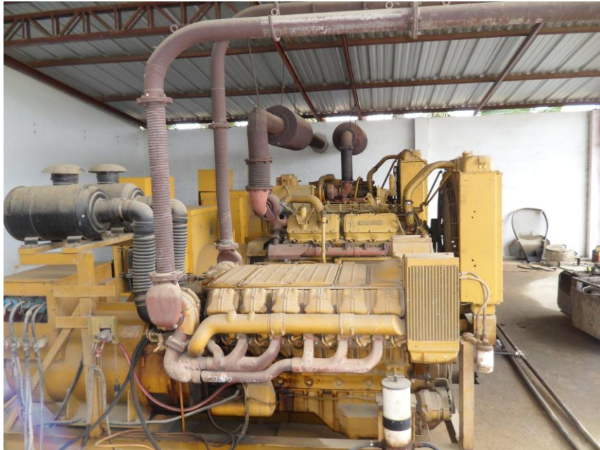
Figura 3.3 Área de motores de combustión interna 22
