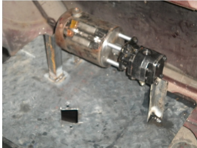
Figura 4.35. Anclaje Conjunto Bomba – Motor Eléctrico
