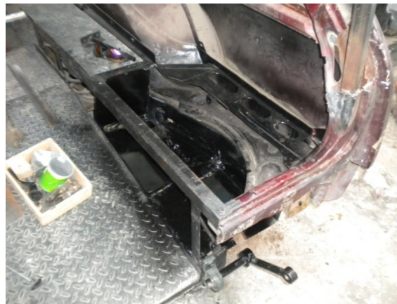
Figura 4.38. Aplicación de aislante y pintura en Espacio a ocupar por el Cilindro Hidráulico
