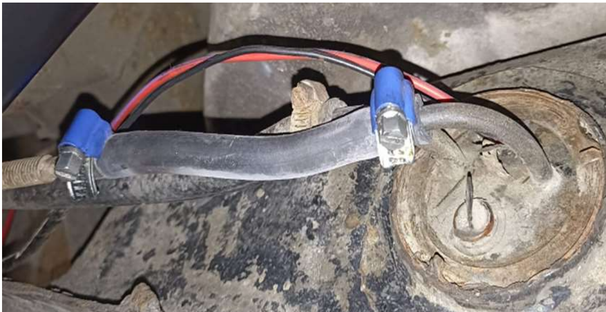
Conexión Eléctrica de la Bomba de Combustible
