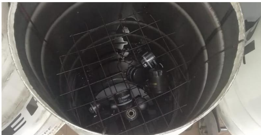
Drenado de Filtros de Aceite
