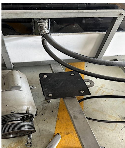
Aislamiento de Vibración en la Base del Motor
