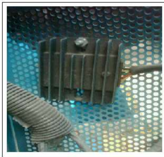
Figura2.4 Regulador de Voltaje.
