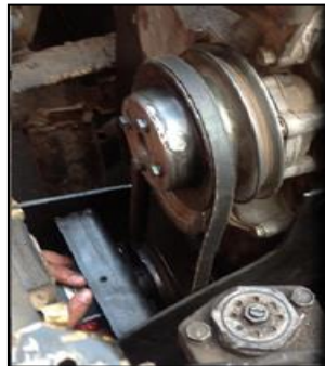
Gráfico 1.15 Instalación de Bomba hidráulica
