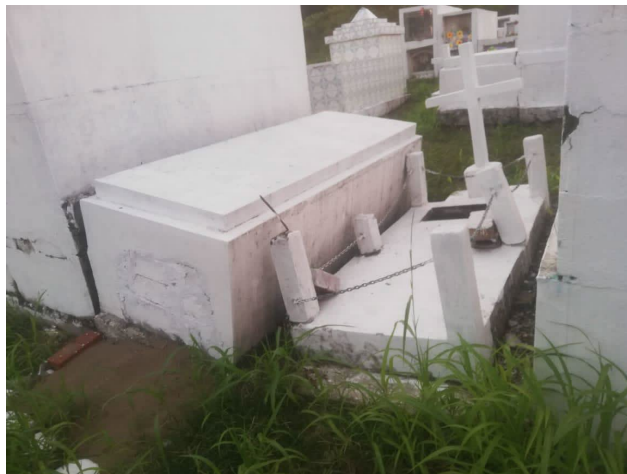
Nota. Tumbas deterioradas [Fotografía], por Jimenez, 2022
