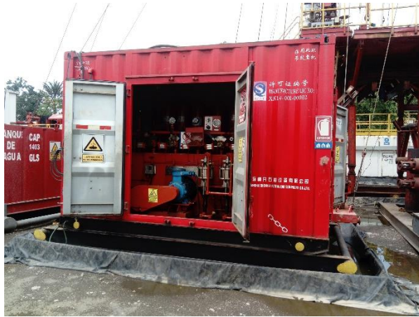
Figura 30. Unidad acumuladora de sistema de seguridad de un taladro de reacondicionamiento
