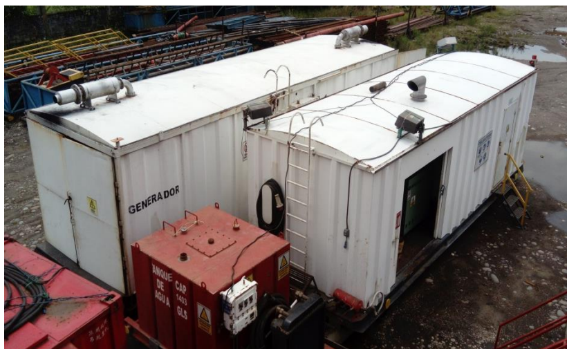
Figura 25. Sistema de generación y transmisión de potencia
