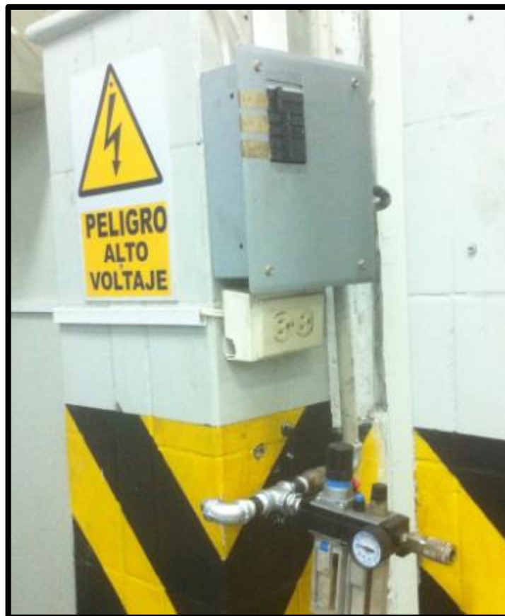
Figura 39. Cajetín de breakers eléctricos
