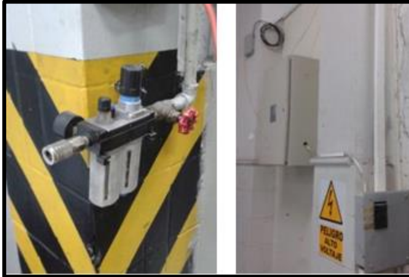
Figura 34. Tomas eléctricas y neumáticas
