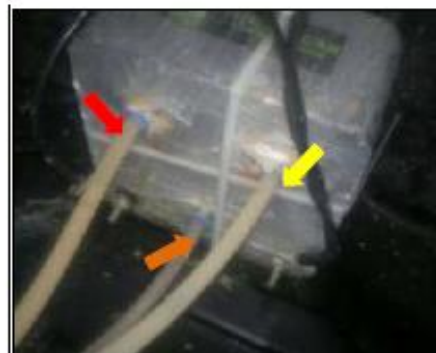
Figura 3-2 Mangueras de conexión del generador al depósito
