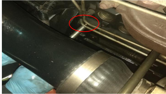
Figura 50. Ubicación desajuste del tapón de drenaje del refrigerante del bloque. (Peso, 2018)
