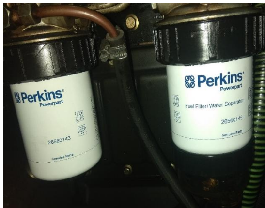
Figura 59. Filtros de combustible cambiados. (Peso, 2018)
