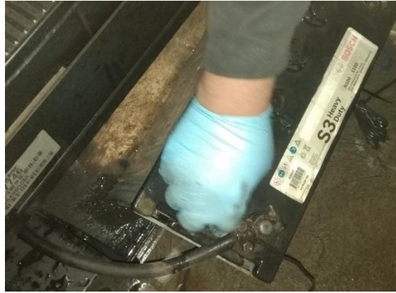
Figura 74. Presencia de sulfato en los bornes de la batería. (Peso, 2018)
