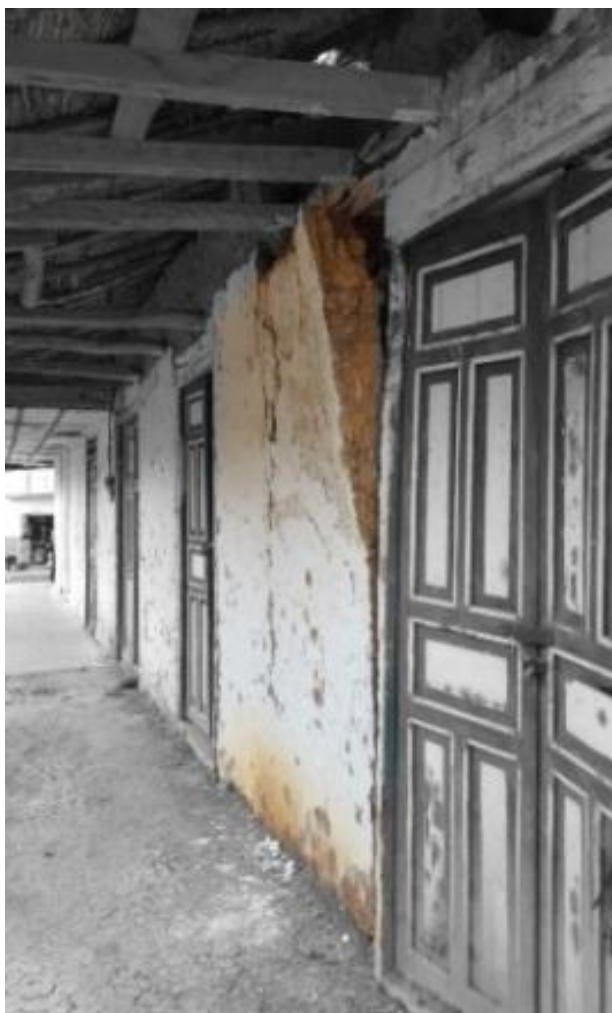
Fotografía 4. Lesiones debido a desaplomes de los muros
