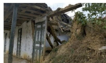
PÉRDIDA DE MURO DEBIDO A COLAPSO DE CUBIERTA
