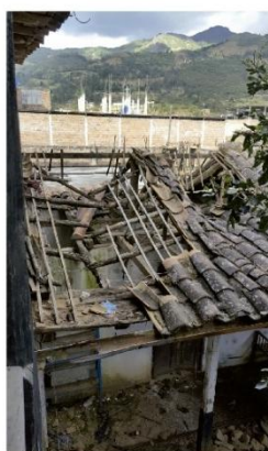
PÉRDIDA DE CUBIERTA PARTE POSTERIOR
