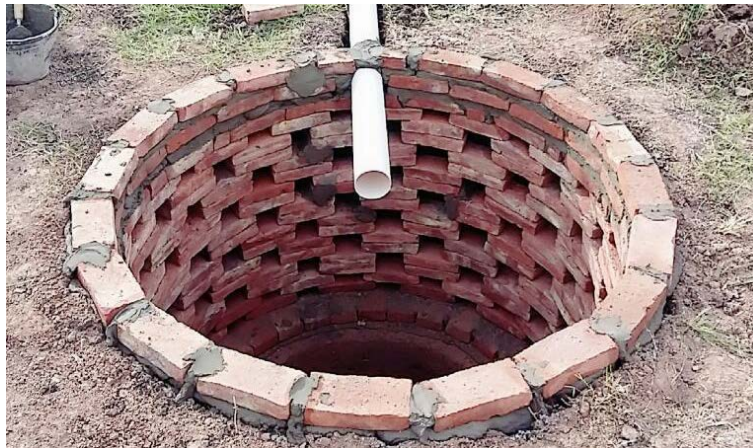
Ilustración 33. Paredes de un pozo ciego
