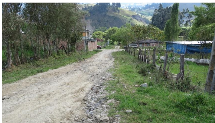
Ilustración 36. Estado actual de cunetas en el barrio El Castillo
