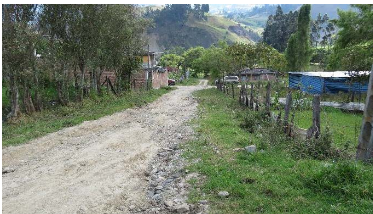
Ilustración 27. Estado vial del barrio El Castillo
