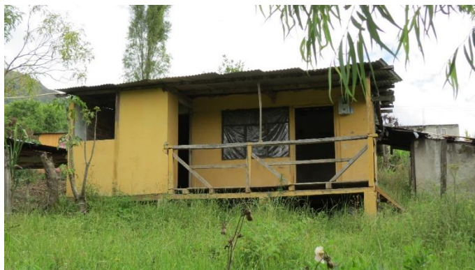
Ilustración 58. Edificación en mal estado
