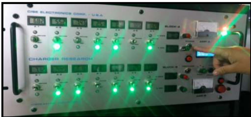
Figura 80. Parámetros de los bloques de celdas en el panel de control principal (Cise Electronics)
