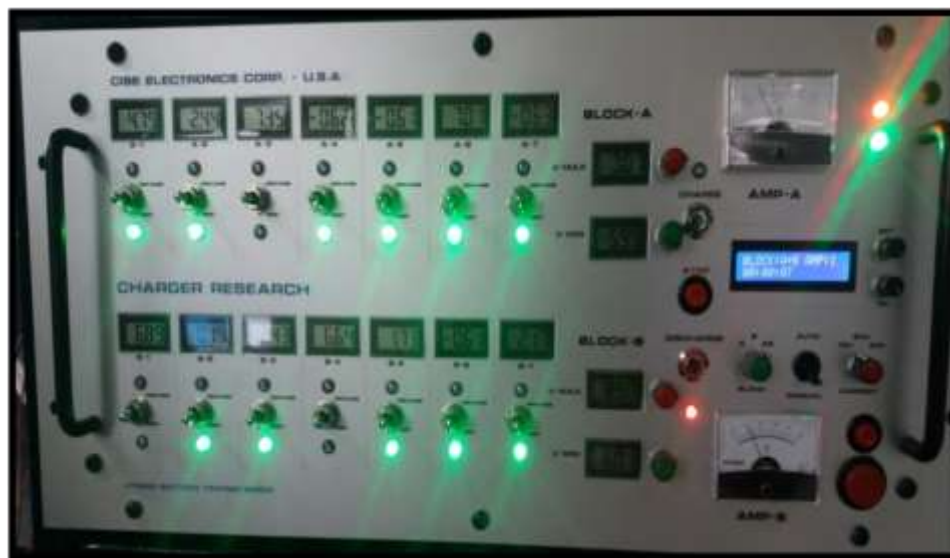
Figura 47. Programación de corriente de descarga en el panel de control Fuente: Cise Electronics
