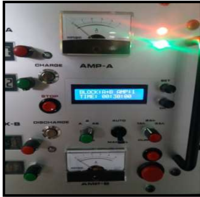
Figura 49. Proceso de precarga de las celdas de la batería (Cise Electronics)
