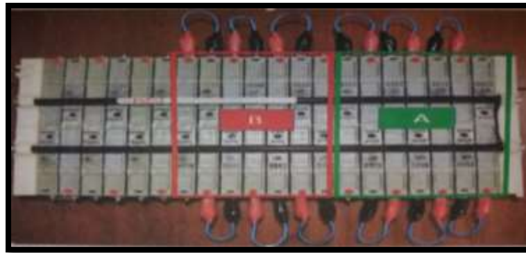
Figura 44. Bloques de celdas de baterías conectados en serie (Cise Electronics)
