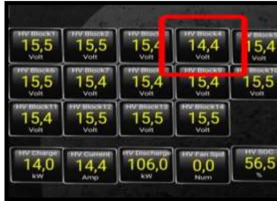
Figura 55. Medición de voltaje de los bloques de celdas de la batería híbrida ( www.diytrade.com/china/pd/7803770/Mongoose_Toyota_MFC.html )
