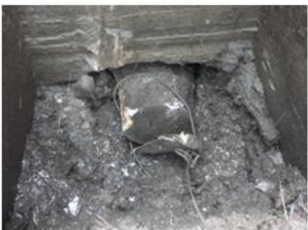
Tronco alojado en tubería del pozo de captación fecha: 13 de marzo de 2011
