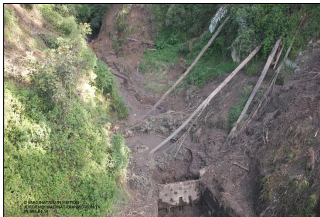
Foto 10: Deslizamiento (sector de la Quebrada Caicedo) Fuente: EMAAPQ
