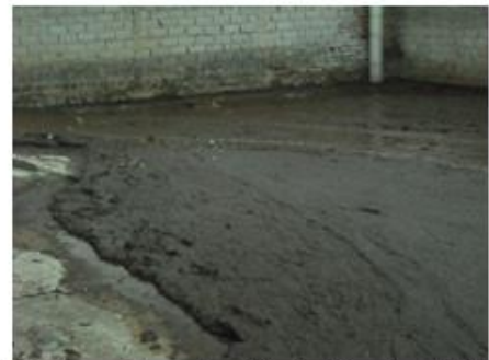
Lodos depositados en las calles San Francisco y Mariano Echeverría, provenientes de la red sanitaria-pluvial fecha: 19 de marzo de 2011
