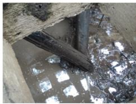
Presencia de sólidos en pozo de captación fecha: 11 de marzo de 2011
