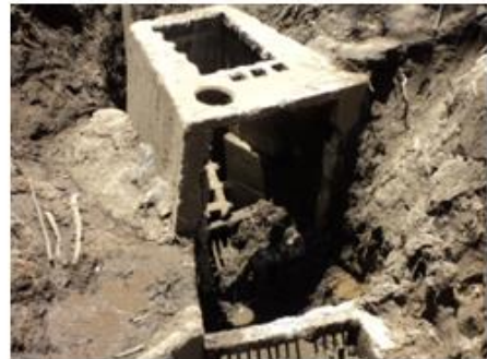
Daños en la estructura del pozo de captación fecha: 19 de marzo de 2011
