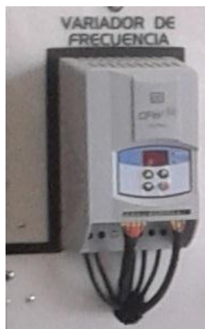
Figura 102 Variador de frecuencia
