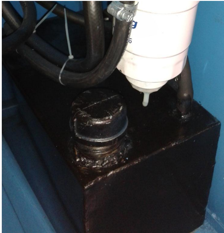
Figura 105 Tanque de combustible
