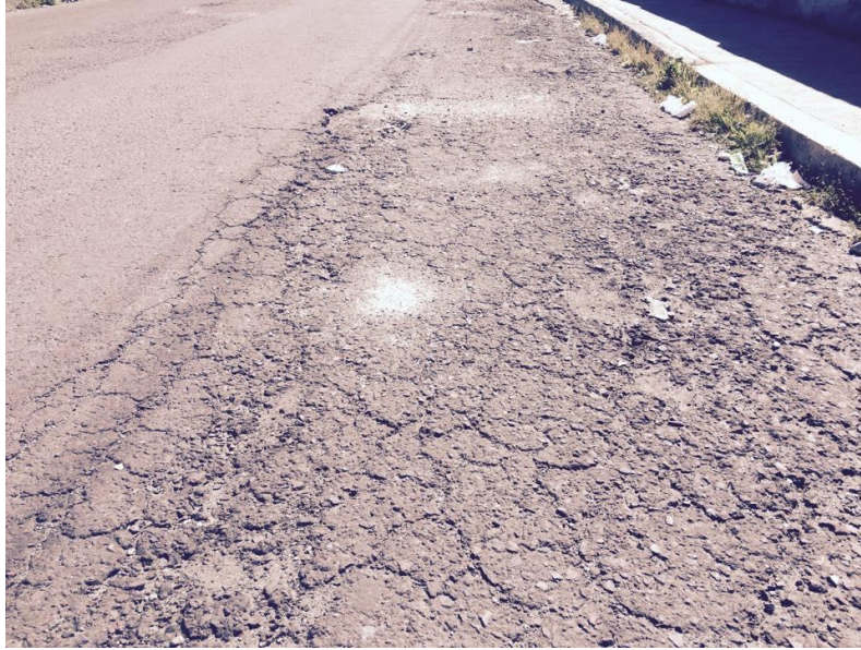
Figura 1: Ejemplo extremo de fracaso de pavimento por suelos inestables. Fuente: Erick Gavilanes Bayas.
