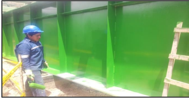
Ilustración 8.- Pintura en vigas FUENTE: Acueducto 1 – Ramal San Antonio AUTOR: Miriam Quilumba
