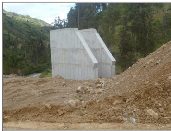
Ilustración 4.- Estribo A sin relleno
