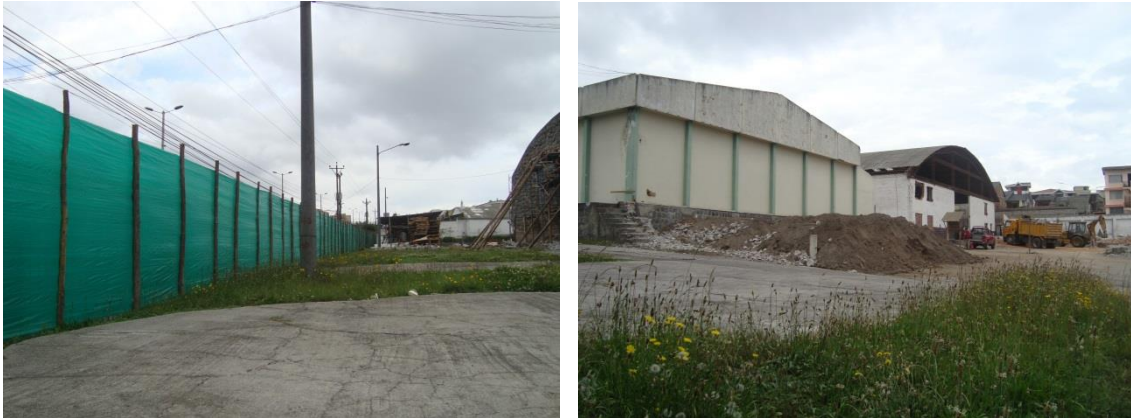
Fig. 20 Demarcación e inicio de demolición, no existe señalización
