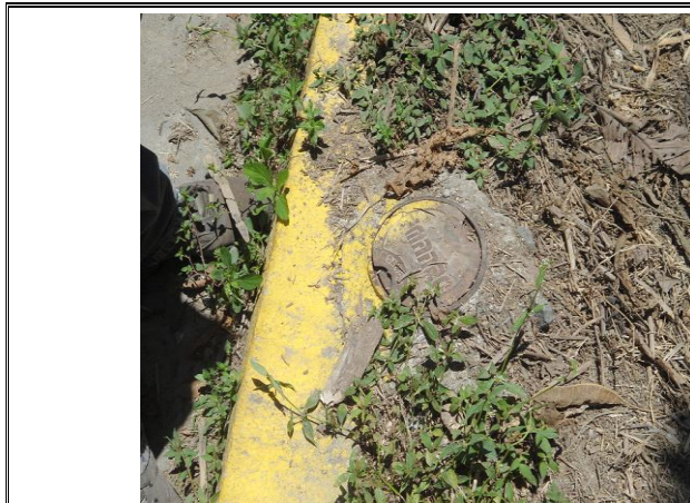
Válvula que controla caudal al sector del estadio
