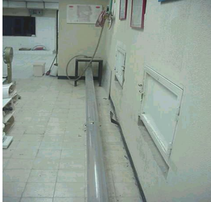
Figura 27.Desplazamiento de solidos Fuente: BRIGGS INDUSTRIES
