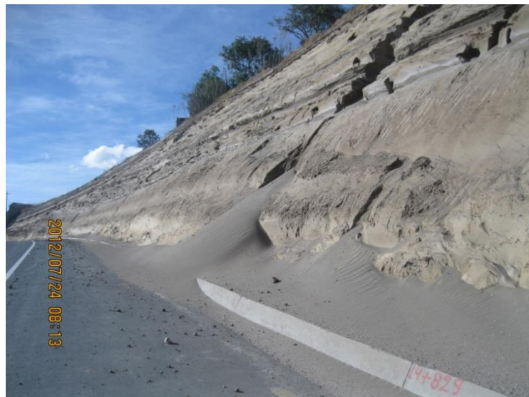
Fotografía 13.- Vista lateral de los deslizamientos (Fuente propia)
