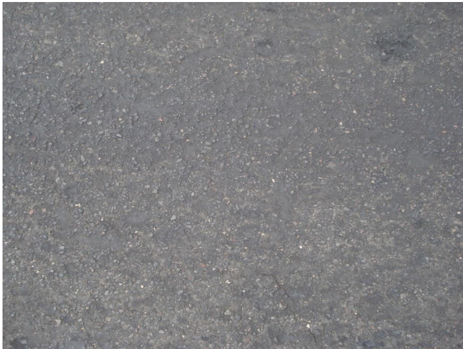
Fotografía No. 9 Desgaste de la capa de rodadura (Km 21+300)
