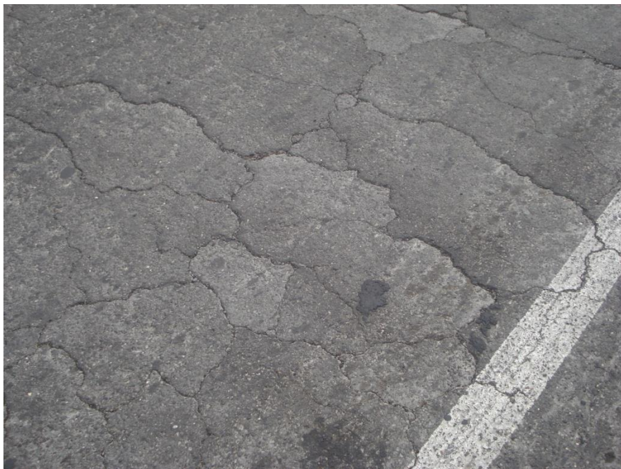
Fotografía No. 11 Fisuración en bloque (Km 21+420)
