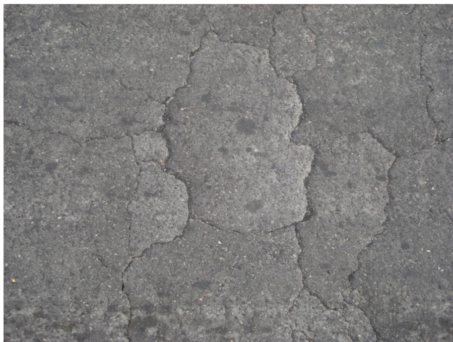
Fotografía No. 12 Fisuración piel de cocodrilo (Km 20+560)
