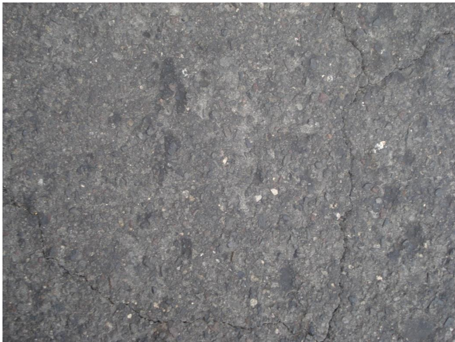
Fotografía No. 10 Desgaste de la capa de rodadura y fisuración (Km 21+360)
