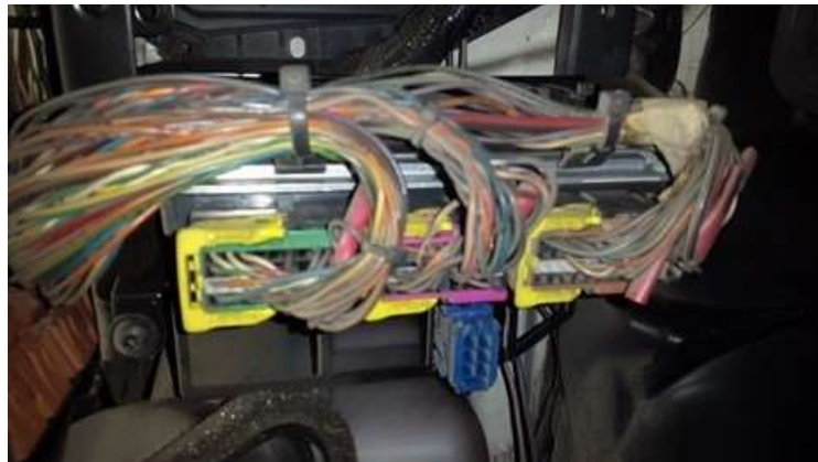
Figura 15 Mazo de cables
