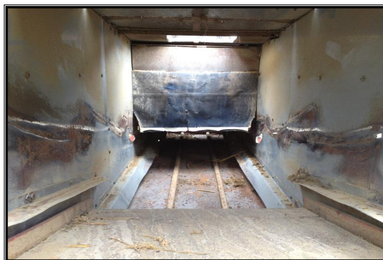
Figura 4.8. Túnel interior sin accesorios con daños visibles
