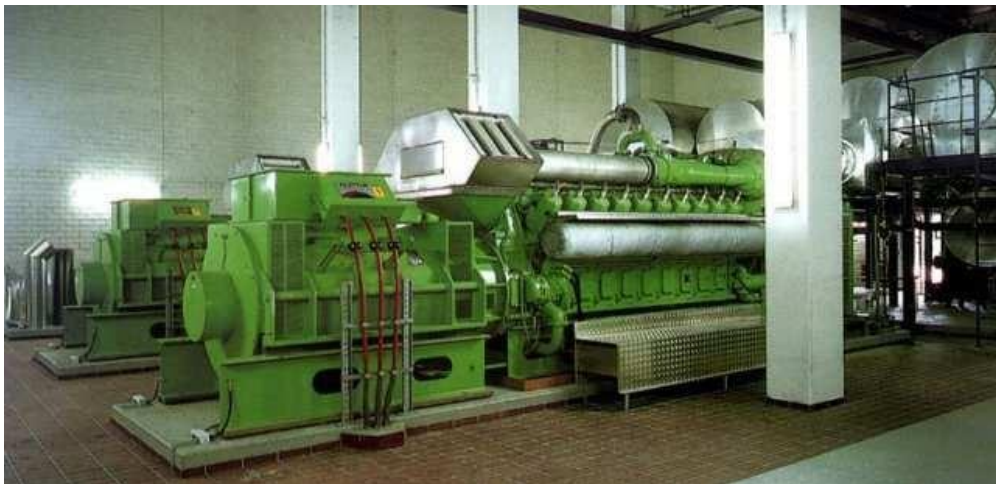
Figura 2. Motor de gas JENBACHER
