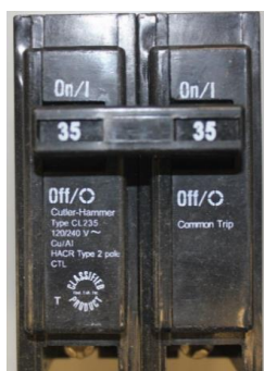
Foto 18 Breaker de 35Amp 220v
