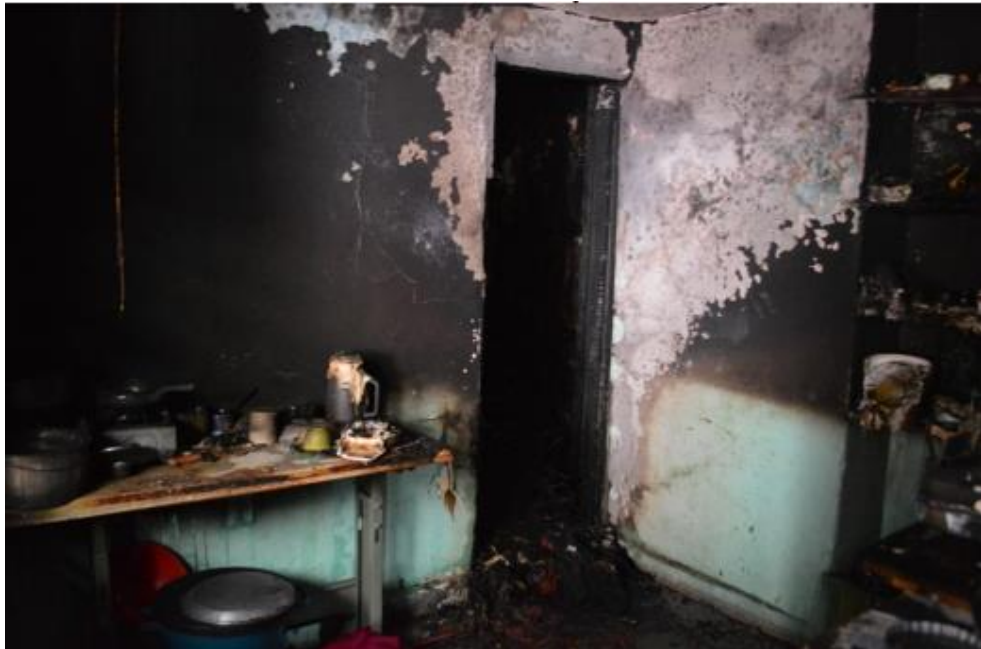
Foto 7 Incendio de Vivienda Centro histórico 2014.
