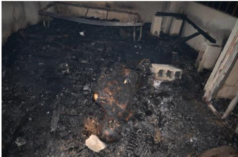
Foto 11 Incendio en vivienda Pisuli 2014.
