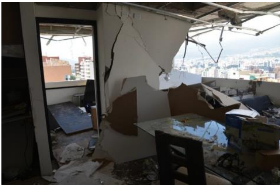
Foto 9 Explosión en Edificio Appenzel.
