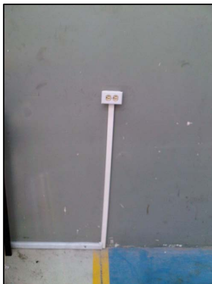
Foto 4.36 Punto Eléctrico No. 2
