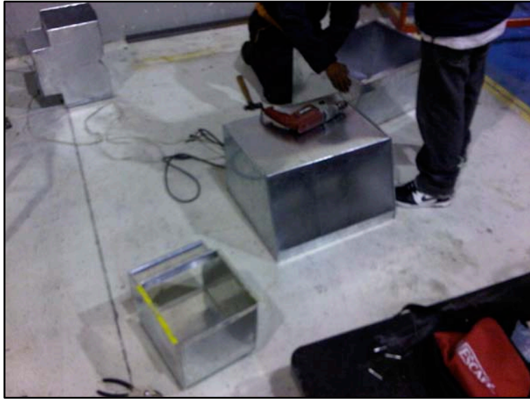
Foto 3.26 Unión de Ductos
