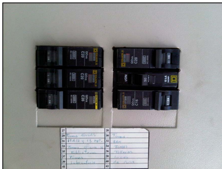
Foto 4.34 Caja Principal de Brakers
