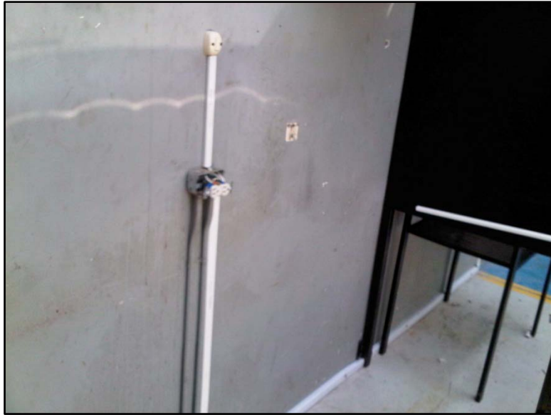
Foto 4.35 Instalación Eléctrica con Canaletas
