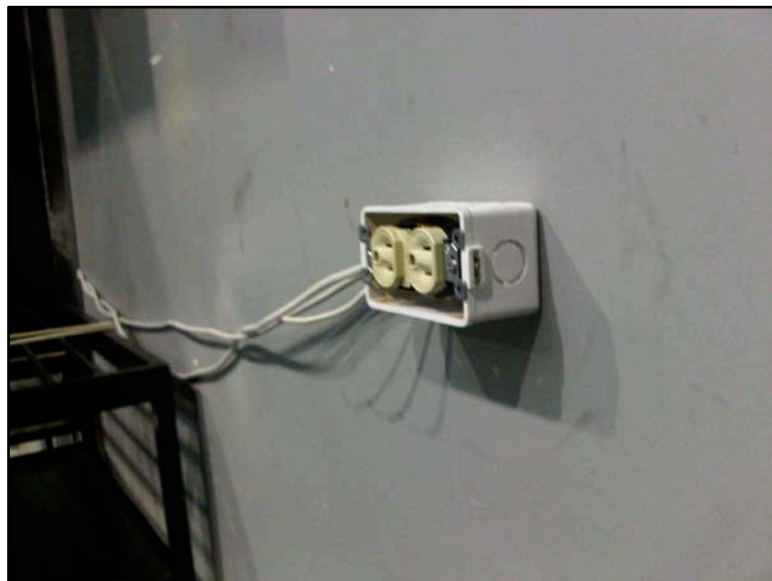
Foto 3.30 Punto Eléctrico No.2
