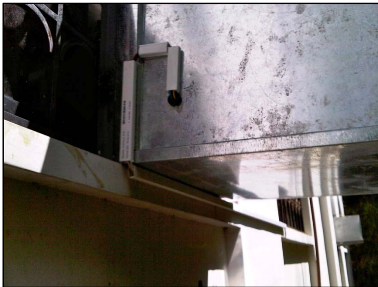
Foto 4.38 Cableado Exterior Cubierto
