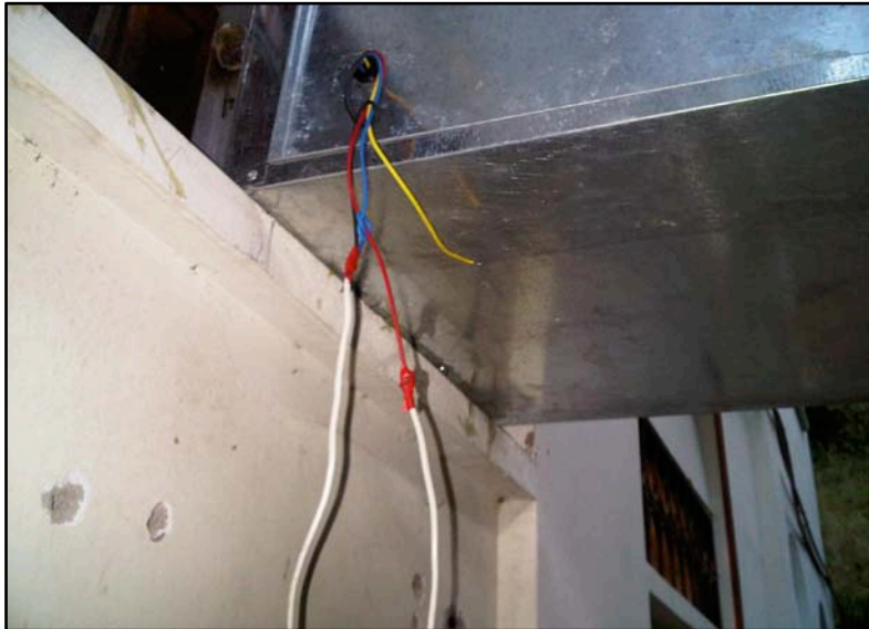
Foto 3.31 Conexión de Extractor a 110v
