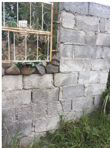
Foto 14: Fisura no estructural del cerramiento de la casa N° 4. Autor: Javier Donoso.
