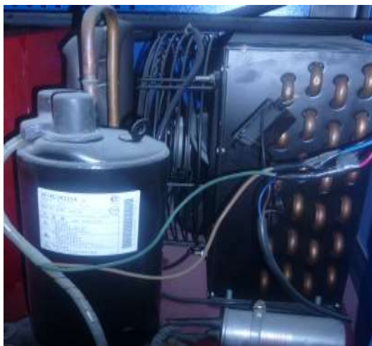
Figura. 27 Radiador del banco de calibración Fuente: El autor
