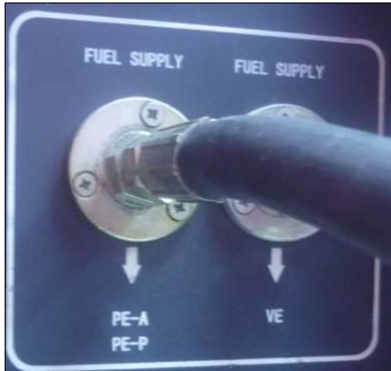
Figura. 29 Conexión de la alimentación del combustible Fuente: El autor
