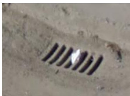
Rejilla de alcantarillado publico
