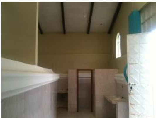
Ilustración 61. Interior del equipamiento de aguas sulfurosas
