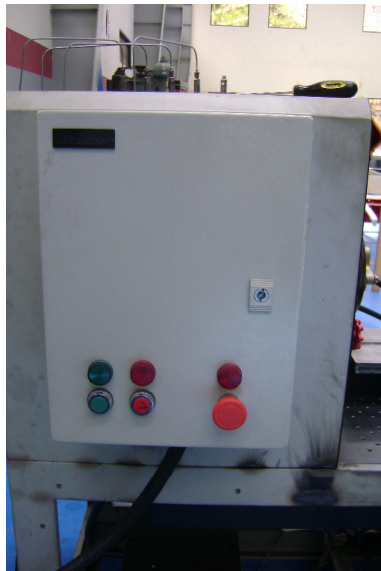
Figura. 4.2. Ubicación del cajetín eléctrico de mando
