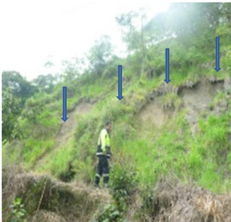
Entrada al barrio "Los Puentes" talud deforestado lo cual provoca inestabilidad
