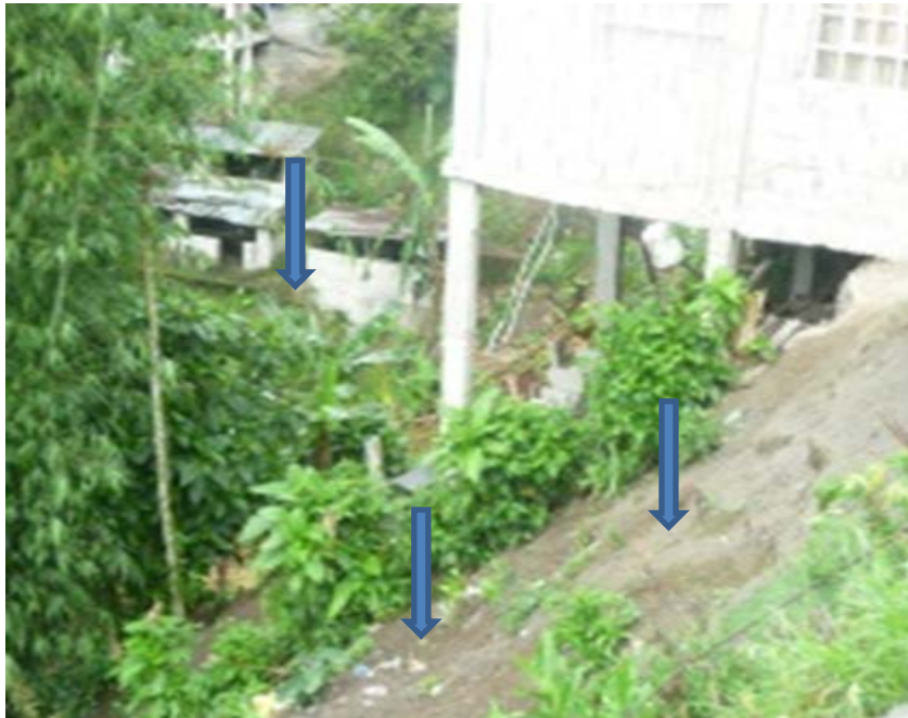
Viviendas construidas sin asesoramiento técnico, laderas inestables en el Barrio Hospitalario
