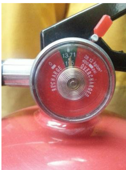
Figura 4.2. Manómetro de extintor de Polvo Químico seco, en rango correcto.
