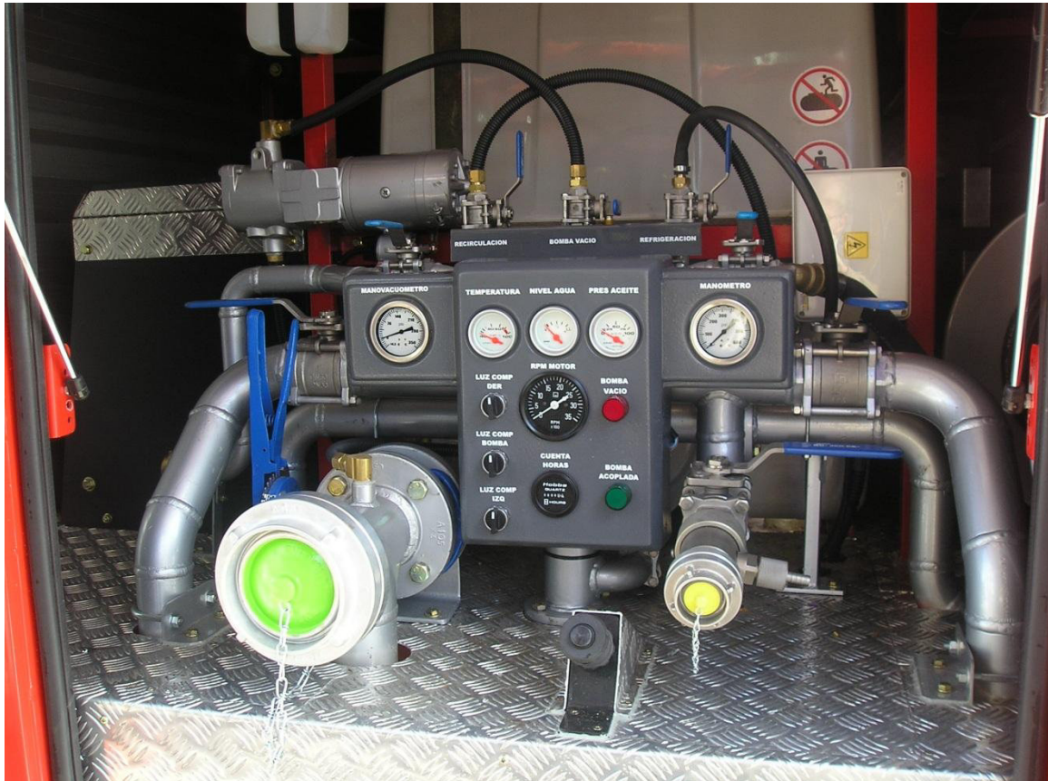
Figura 2.6. Tablero de mandos.
