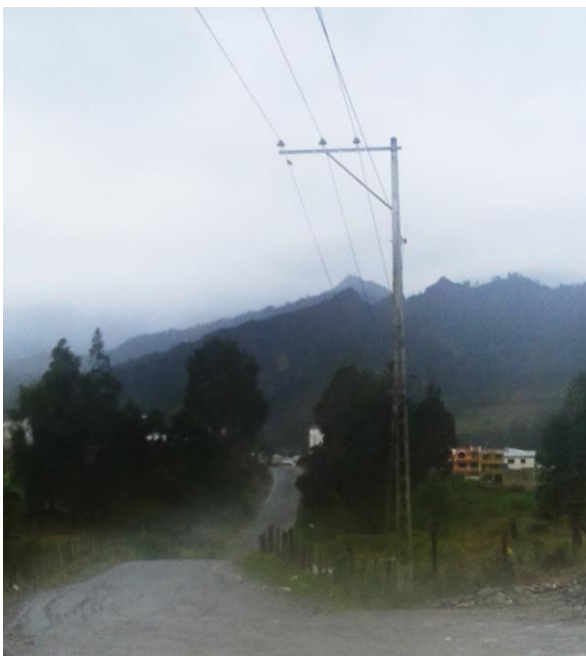
Ilustración 72. Servicio de Energía Eléctrica
