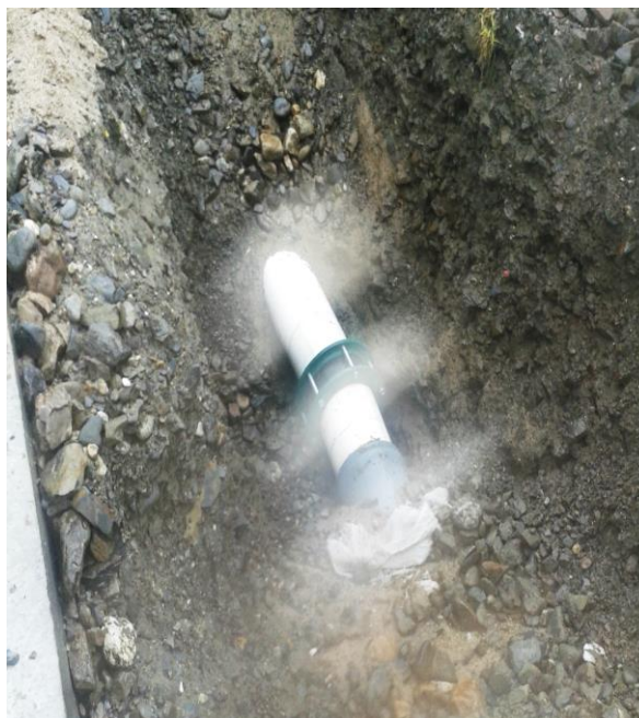
Ilustración 73. Tubería del Alcantarillado
